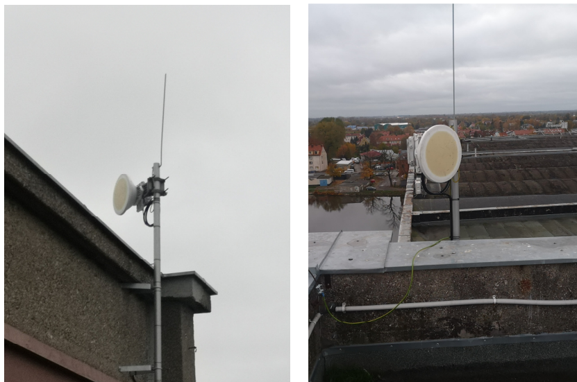
Widok obiektu wraz z zainstalowanym zespołem antenowym
