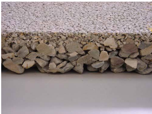
Rys. 9.11. Budowa nawierzchni dwuwarstwowej (Evaluation of U.S. and European Concrete Pavement Noise Reduction Methods, National Concrete Pavement Technology Center, 2006)
