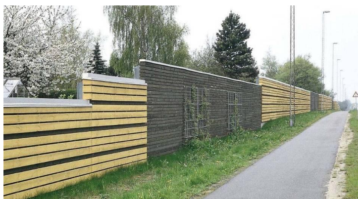
Rys. 9.15. Ekran przeciwhałasowy (cegła, drewno)
