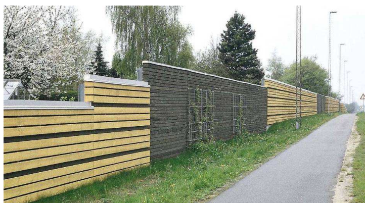
Rys. 10.16. Ekran przeciwhałasowy (cegła, drewno)
